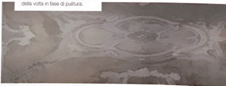
APPARTAMENTO DELLA DUCHESSA DI GENOVA: parte della volta in fase di pulitura.
